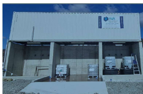
Filtro prensa en container montado sobre estructura de hormigón para recogida de tortas
