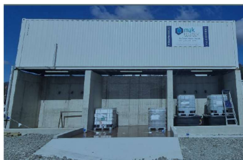
Filtre-pressé dans un conteneur monté sur une structure en béton pour la récupération du gâteau de filtration
